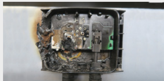
Bild 2: Verbrannte Anschlussdose durch korrodierte Kontakte
